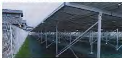
②磐田市上野部の太陽光発電設備
