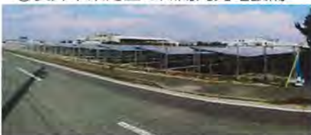
①袋井市東同笠の太陽光発電設備
